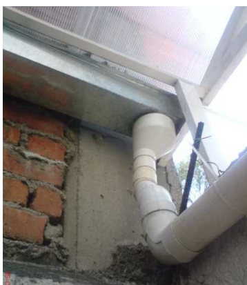
Figura 5.2. Canaleta de zinc y tubería de PVC.
